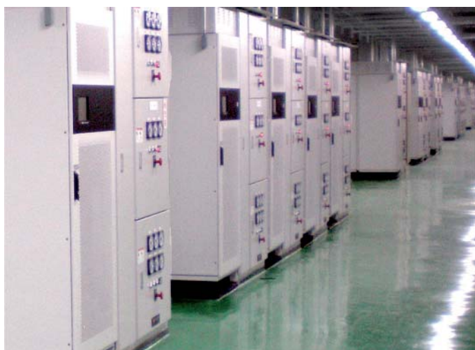
Пример применения PCS 100 UPS-I: завод по производству полупроводников
